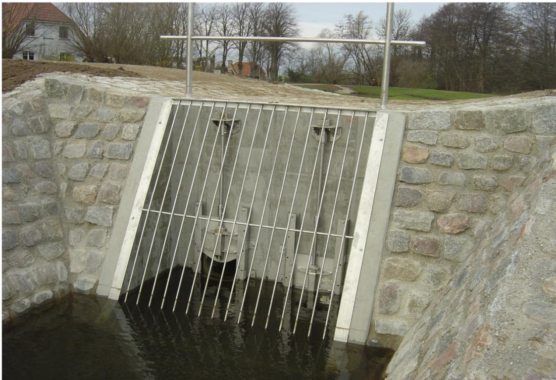
Zwischenstufendrossel Verbindung Becken 1 mit Becken 2
